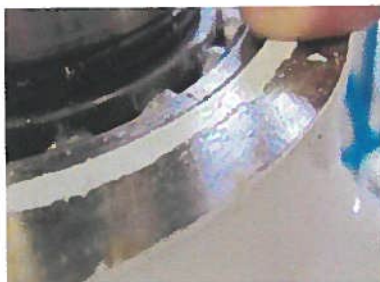
Obrázek 1 : příklad nevyhovující jednotky
